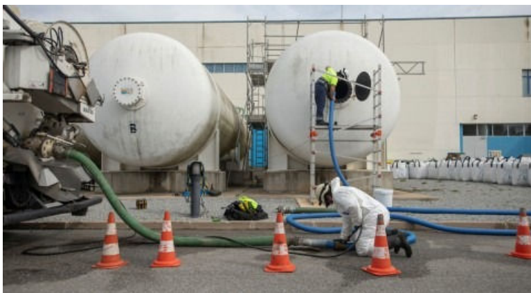
Desalinizadora de la Tordera, Blanes, Girona. Febrero 2024
