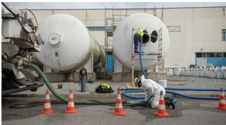
Desalinizadora de la Tordera, Blanes, Girona. Febrero 2024
